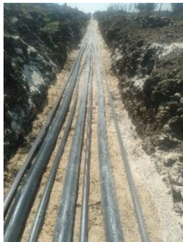
Fig. 2.10 Cabluri subterane de medie și înaltă tensiune.
