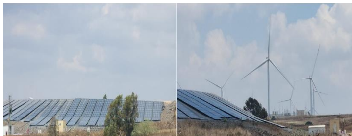
Fig. 4.7 Parc eolian, parc fotovoltaic și stație de transformare.
