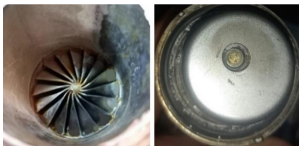
Fig. 5.11. Starea inițială a mixerului SCR și a injectorului de AdBlue înainte de efectuarea testelor.
