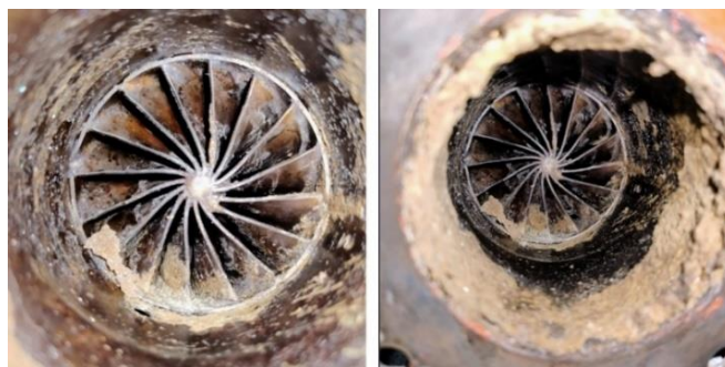
Fig. 5.13. Efectele îmbătrânirii depunerilor sărurilor de uree pe mixerul SCR.
