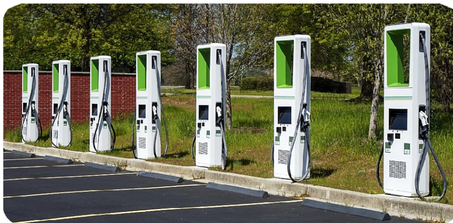
Fig. 3. Sisteme de încărcare moderne pentru autovehiculele cu propulsie electrică sau hibridă [002].
