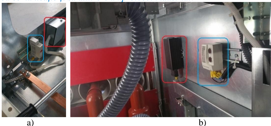
Figura 2-4. Celula primară de distribuție, a)-Sistemul de încălzire din compartimentul de cabluri (TermoHigrostat electronic-încercuit cu albastru, încălzitor-încercuit cu roșu) și b)-Sistemul de încălzire din compartimentul de comutare [120]
